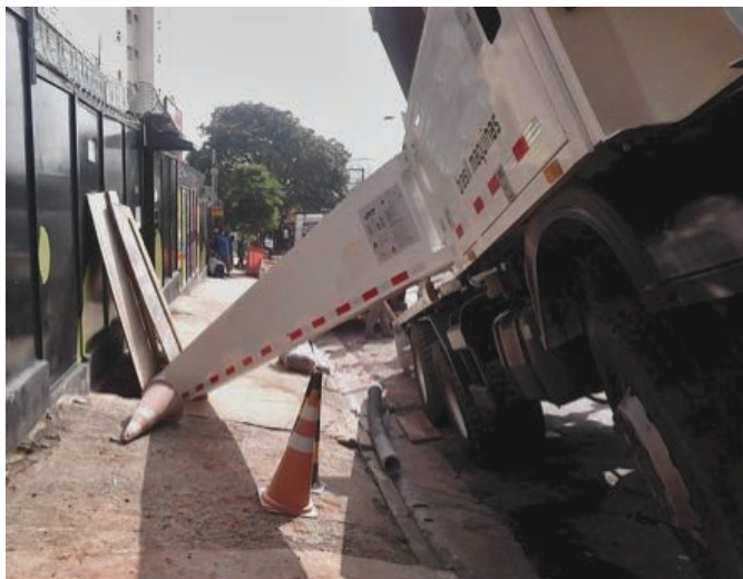
Volcamiento de camión bomba por hundimiento de estabilizador trasero (Chile).
